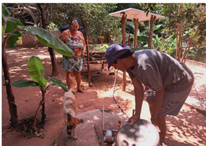
Bomba que funciona através da placa solar, que bombeia a água em direção à última caixa de armazenamento da água tratada
