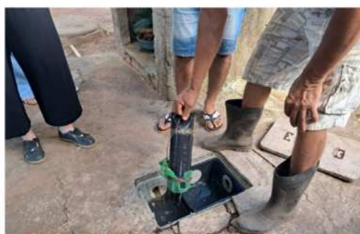
Caixa de gordura que filtra as primeiras impurezas da água
