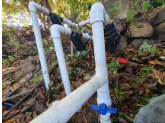
Figura 10: Tubulação do sistema de irrigação
