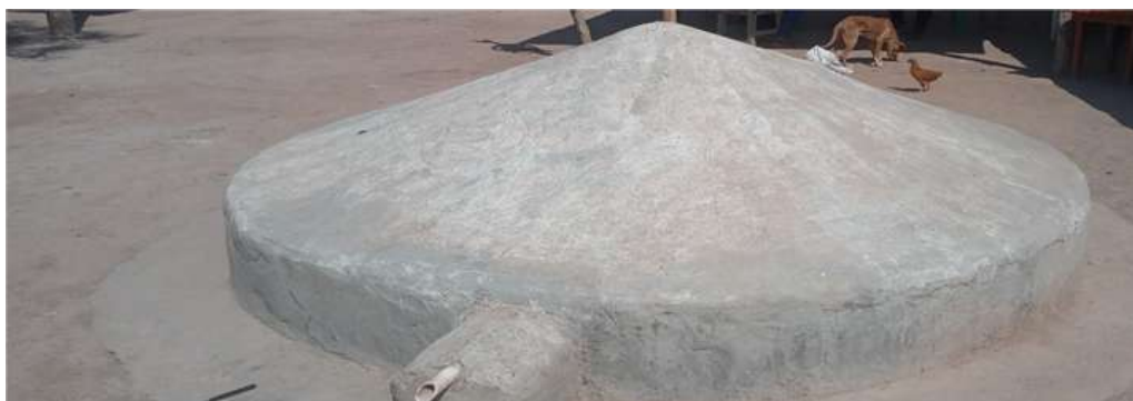
Figura 7: Cisterna para el suministro de agua para el consumo familiar en la comunidad de Cabeza del Toro, Copo/Santiago del Estero/Argentina
