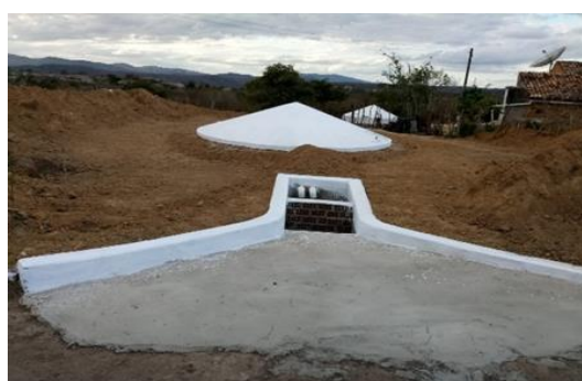
Figura 21 – Cisternas de enxurrada
