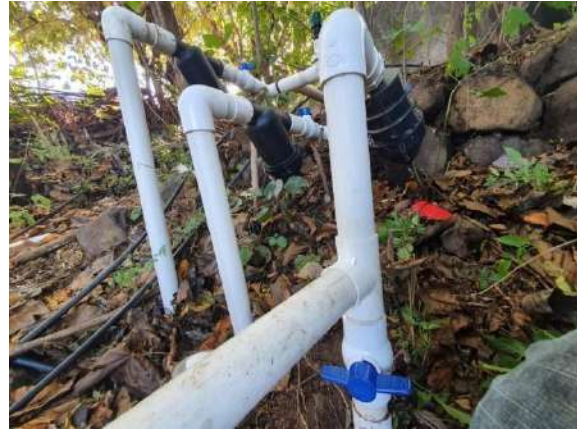
Figura 10: Tubería del sistema de riego
