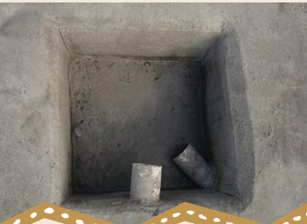
Foto 24 – Detalhe do decantador
