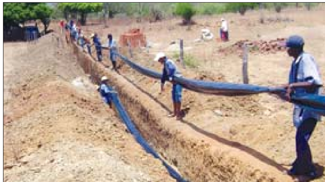
ALTERNATIVA | A barragem subterrânea, construída no sertão do Piauí, armazena água para a população
